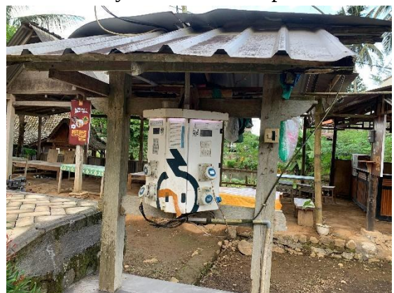
Gambar 10. Instalasi Listrik di Jopuro Sumber: Dokumentasi Pribadi, 2024
